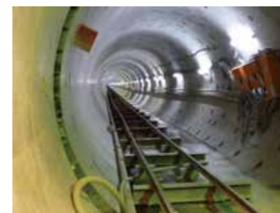
現場における仮設照明をLED化
